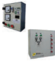
Armoire de commande
